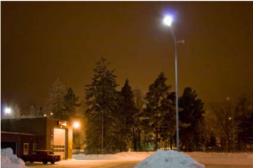
Vänteparkeringen vid stationen. Trasig armatur i bortre kant.
