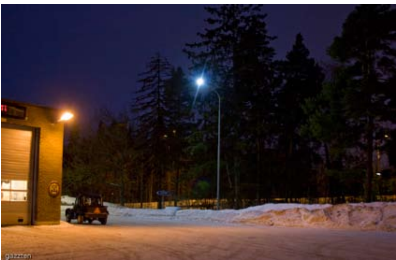
SunFIRE7 LED-armatur monterad.
